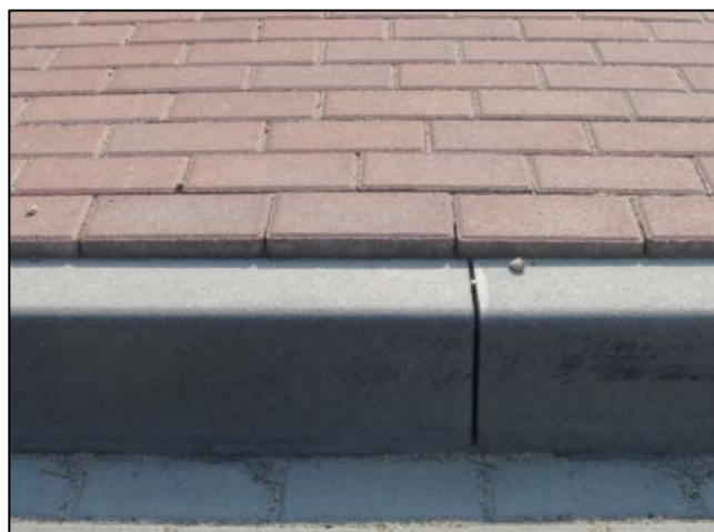
Zdj. 4. Niebezpieczna różnica poziomów
